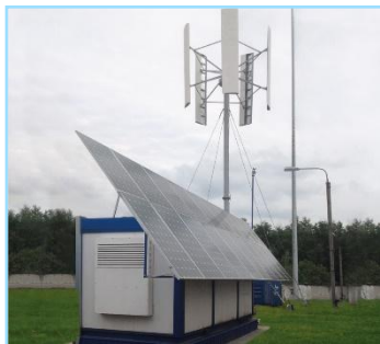
Газпром трансгаз Москва Московское ЛПУ МГ, КРП-16
